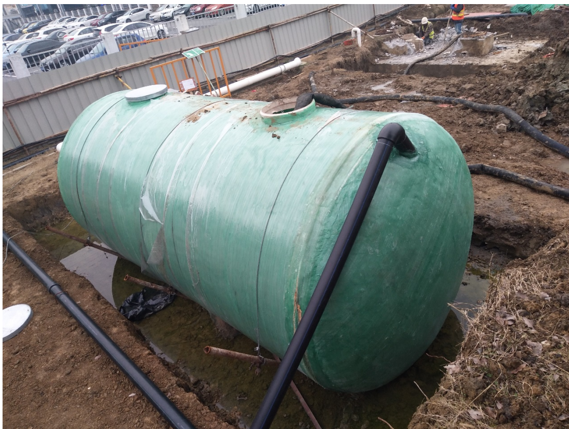
图 6-9 生活废水临时处理罐
