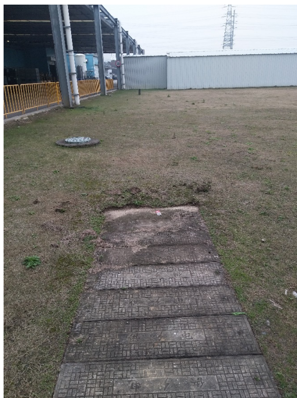
图 6-2 变电站南侧及地下电缆环境图
