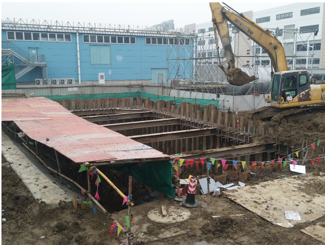
图 6-8 新建污水处理系统
