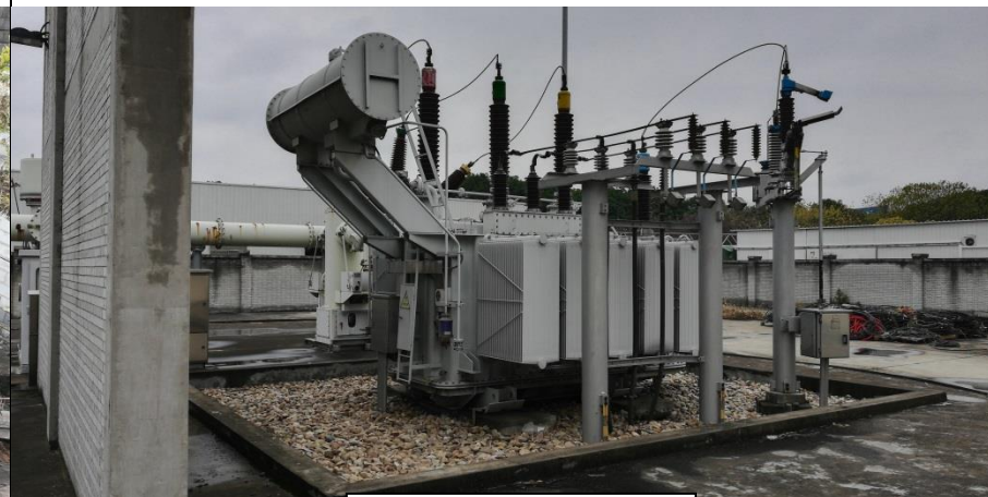
主变下方事故油坑
