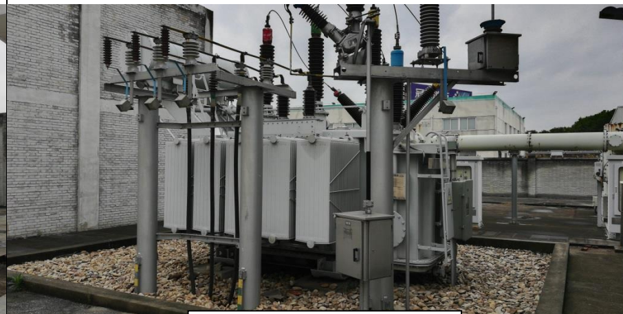
主变下方事故油坑
