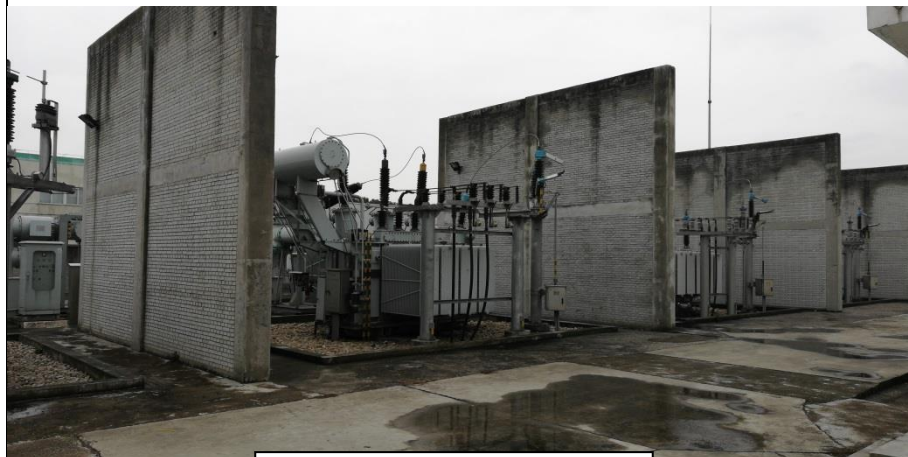
主变压器区域
