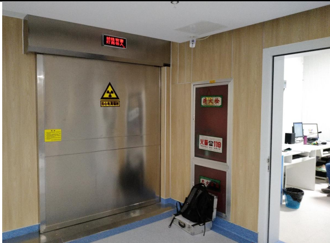
伽玛刀机房防护门工作状态指示灯和电离辐射警示标识
