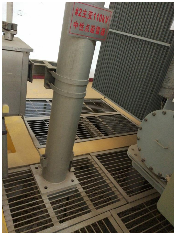
图 11 主变及下方事故油坑
