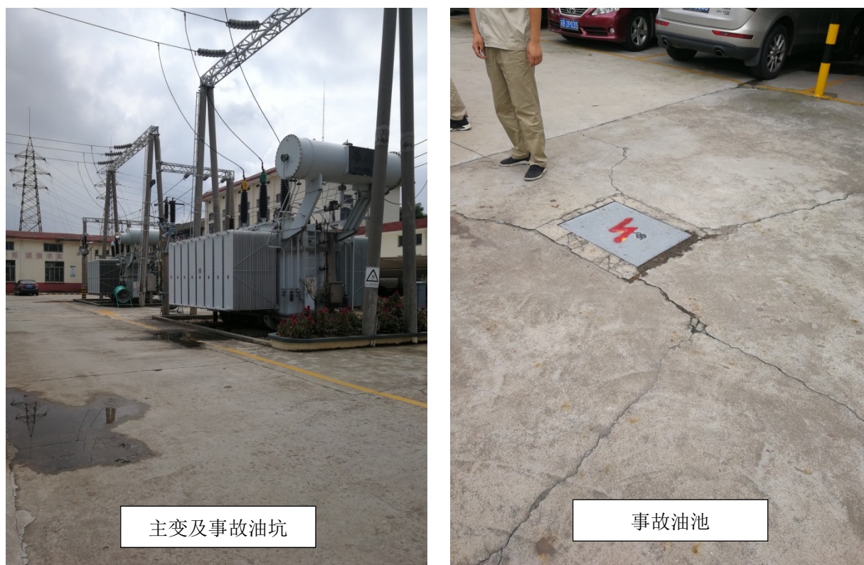
图 6 主变及下方事故油坑、事故油池
